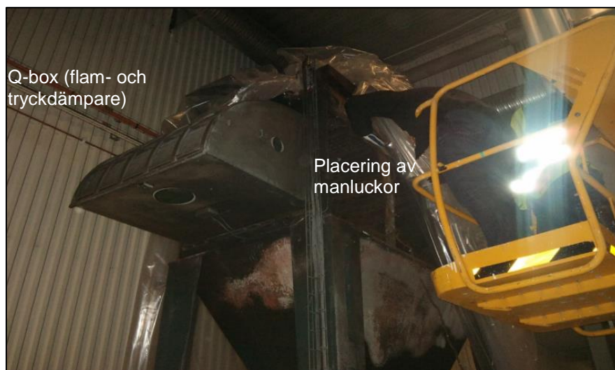
Figur 18. Filter med Q-box och bortsprängda manluckor
