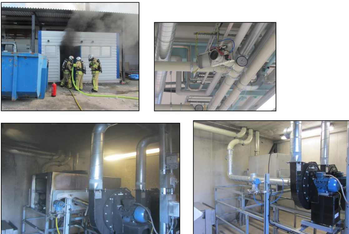
Figur 17 Foton från ytterligare en incident, och där man sedan installerade en ventil i systemet för att öka lufthastigheten. Man demonterade dessutom filterskåpet och evakuerade ventilationsluften ut i det fria. (Nedre foton visar filterrum med respektive utan filterskåp).
