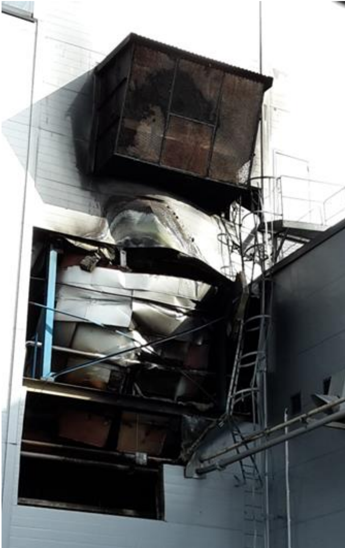
Figur 4. Dammexplosion i filter. Tryckavlastningen har varit otillräcklig, vilket har resulterat i att filtret rämnat.
