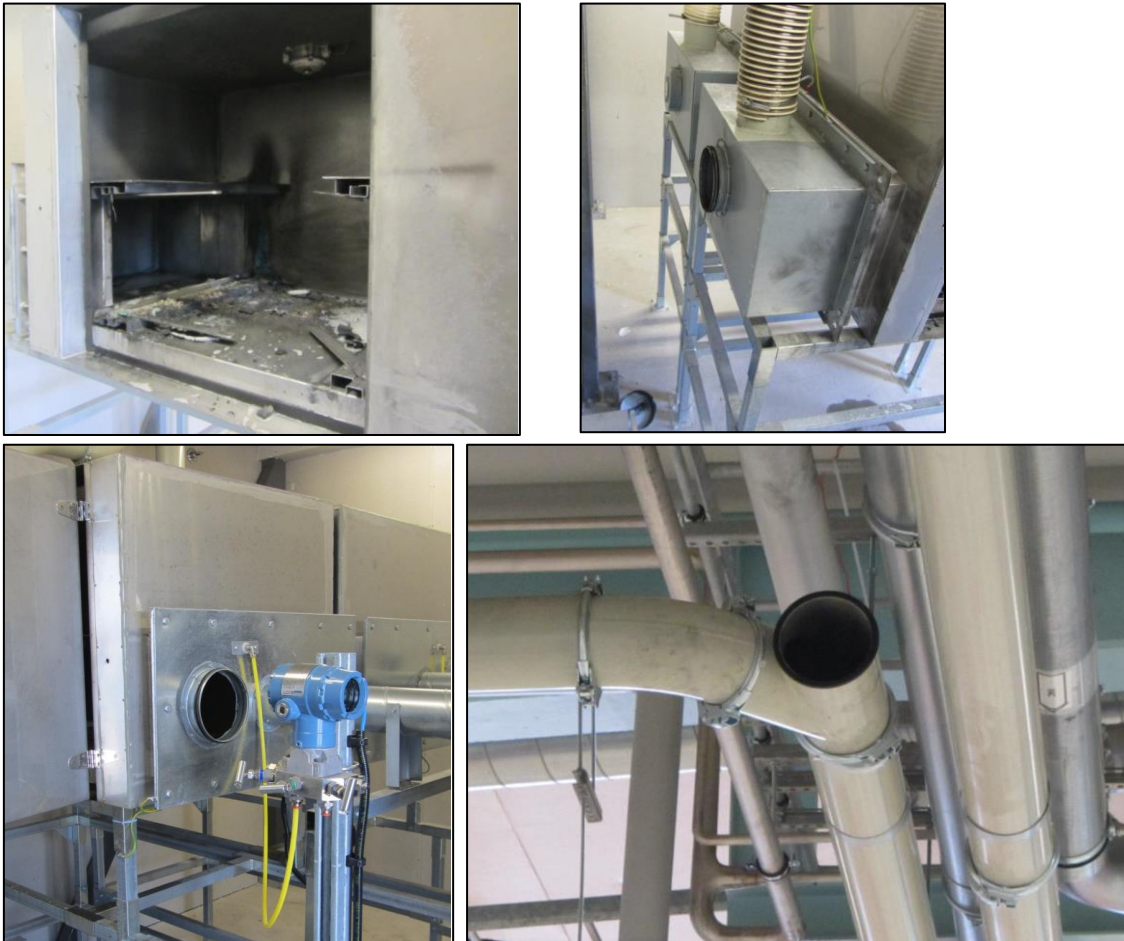
Figur 16. Foton som visar filterkabinettet där tryckavlastningar fungerade och öppnade som de skulle. Även en tryckavlastning i rörsystemet öppnade.
